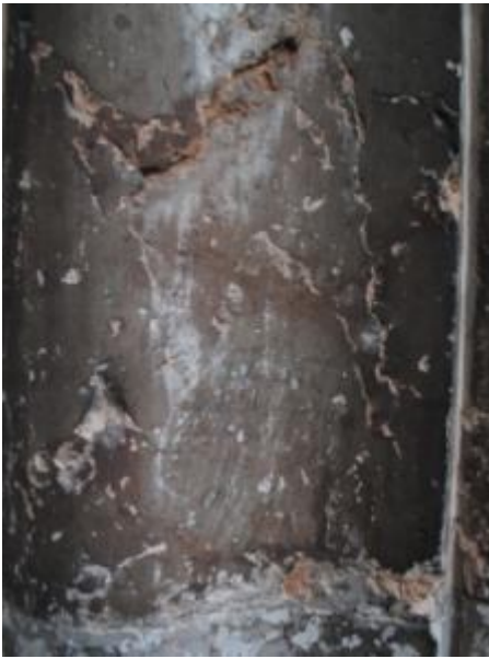
Foto 55. Dettaglio del degrado, 2012
