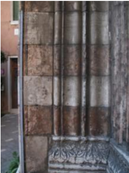
Foto 57. Particolare dello stipite interno e degrado , 2012
