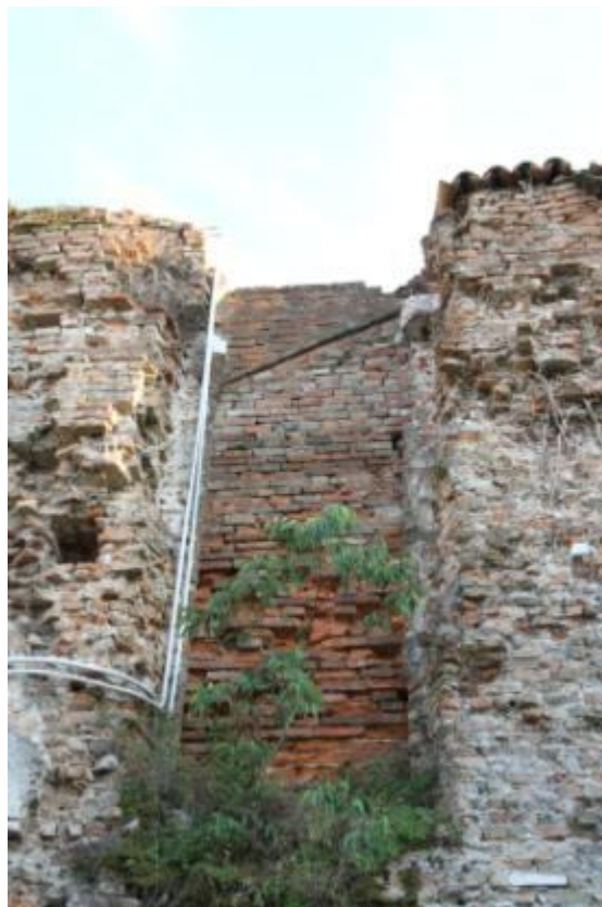
Foto 63. Particolare di una finestra murata, 2012
