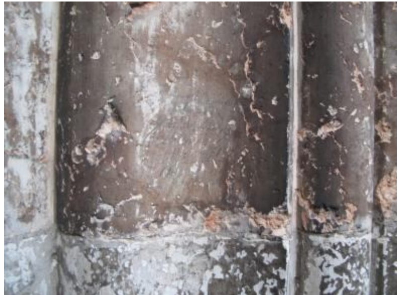
Foto 58. Particolare del degrado, 2012
