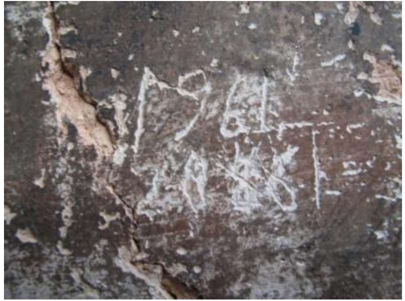
Foto 56. Dettaglio del degrado, 2012
